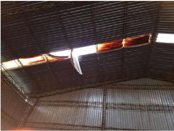
Fotografía 3. Techos en mal estado
