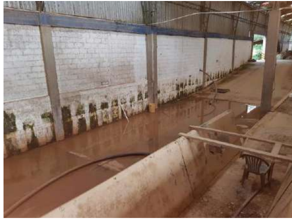
Fotografía 2. Empozamiento dentro de la Planta
