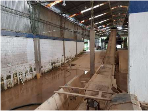
Fotografía 1. Empozamiento dentro de la Planta
