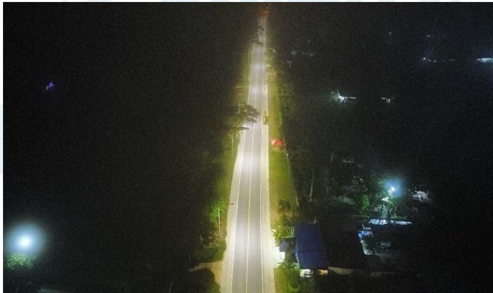
Imagen 5. Modernización LED Corregimiento el Totumo
