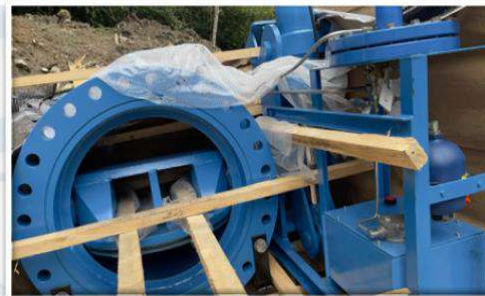
K6+540 Válvula de Sobrevelocidad Fuente: El IBAL S.A. E.S.P Oficial
