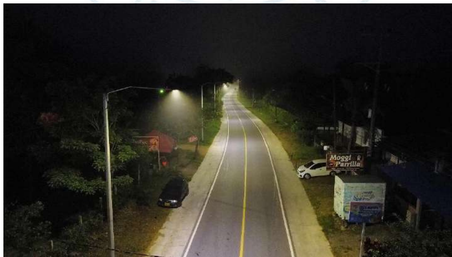
Imagen 6. Modernización LED Corregimiento el Totumo
