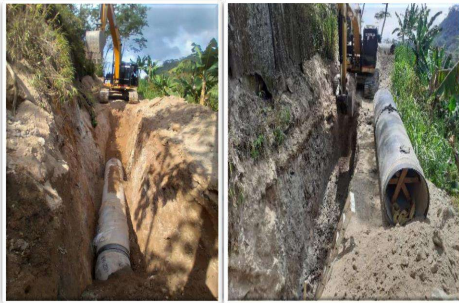
Instalación Tubería 36" Grp, Wsp, Construcción Cárcamo Fuente: El IBAL S.A. E.S.P Oficial
