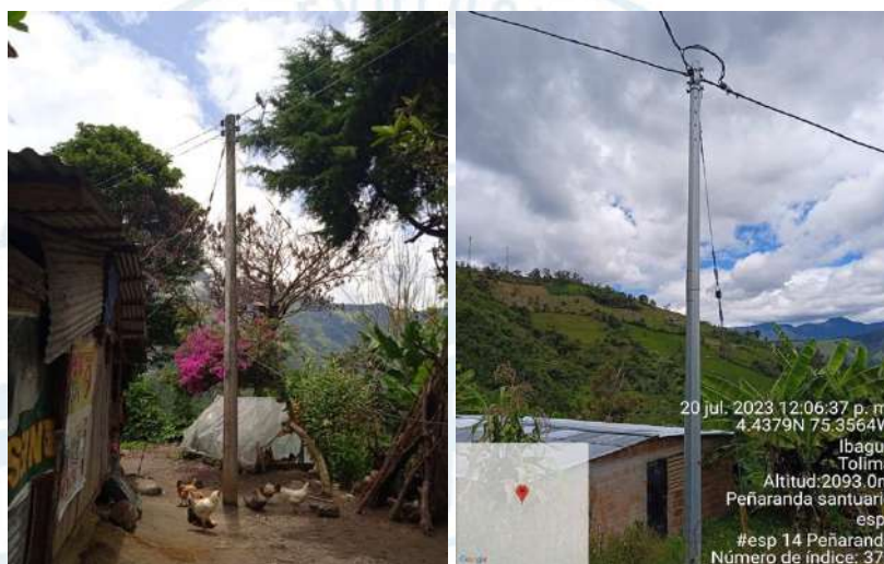
Postes y redes de conducción que electrifican viviendas en la vereda Peñaranda Alta Sector Santuario del corregimiento 5 – Tapias Fuente: Secretaría de Agricultura y Desarrollo Rural
