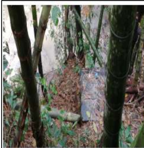
Segunda caja de inspeccion.
