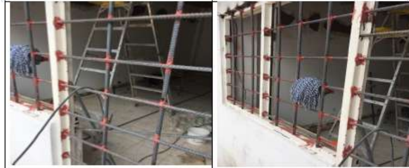
Descripción: Masilla rejas seguridad externa
