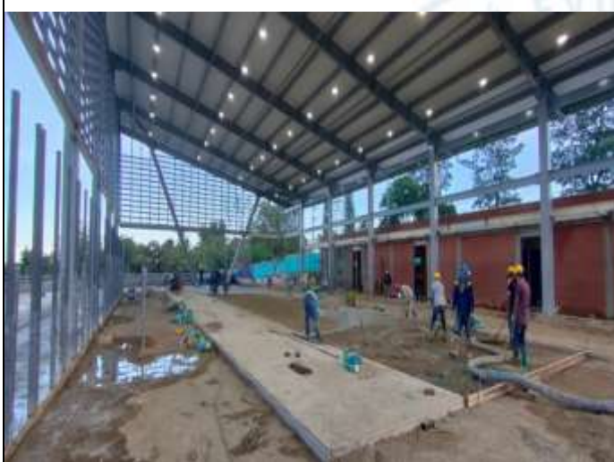
Imagen 7: sistema de red de Iluminación en el área de competencia.
