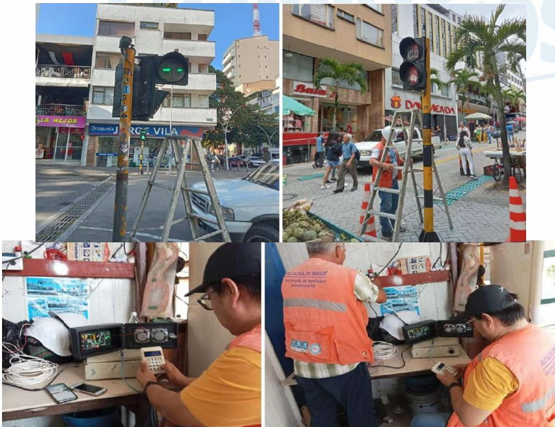
Imagen 13 Intervención controladores semáforo
