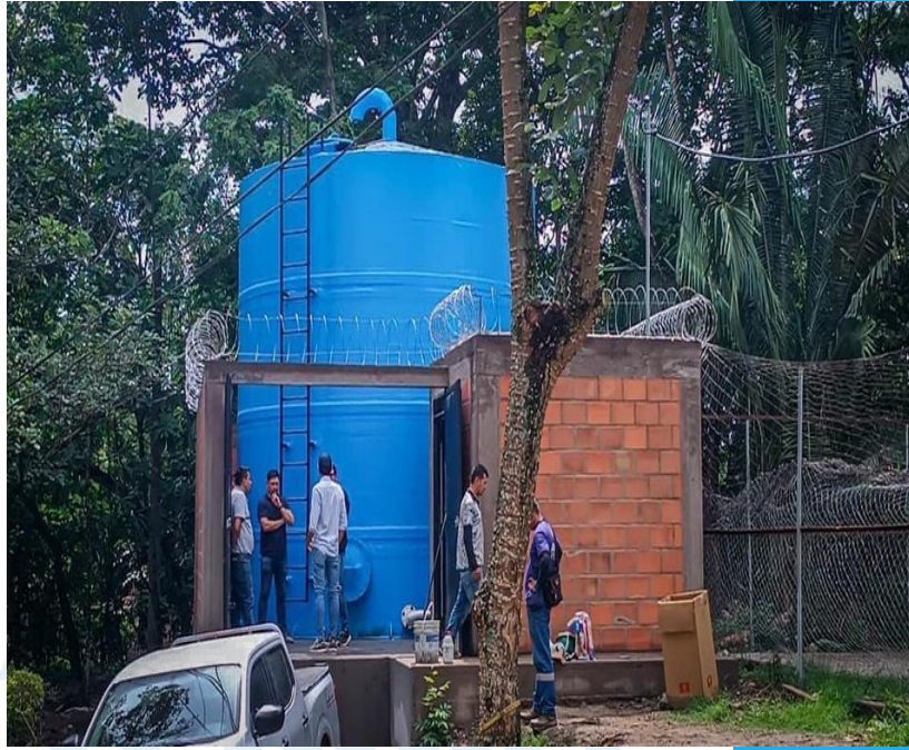
Ilustración 20. Tanque de calcaíma
